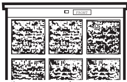
Filtre encrassé – Requiert un nettoyage
